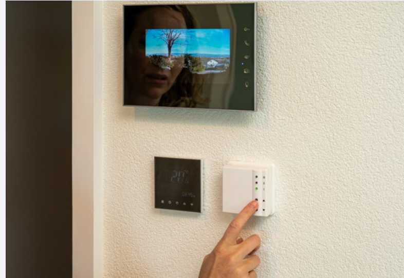
Das denkmalgeschützte Einfamilienhaus in Lyss (BE) aus den 1960er-Jahren weist heute eine topmoderne Haustechnik und Dämmung auf.
